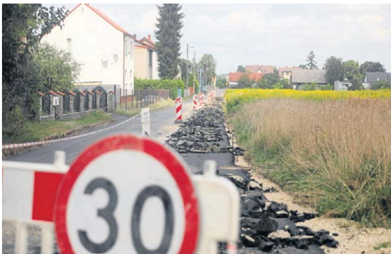
Droga przeorana przez ciągnik ma zostać naprawiona
