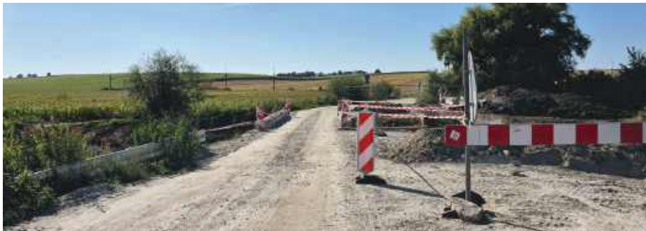
W środę, 9 września, doszło do awaryjnego zamknięcia remontowanego w Białym Kościele mostu. Fot. PZD
