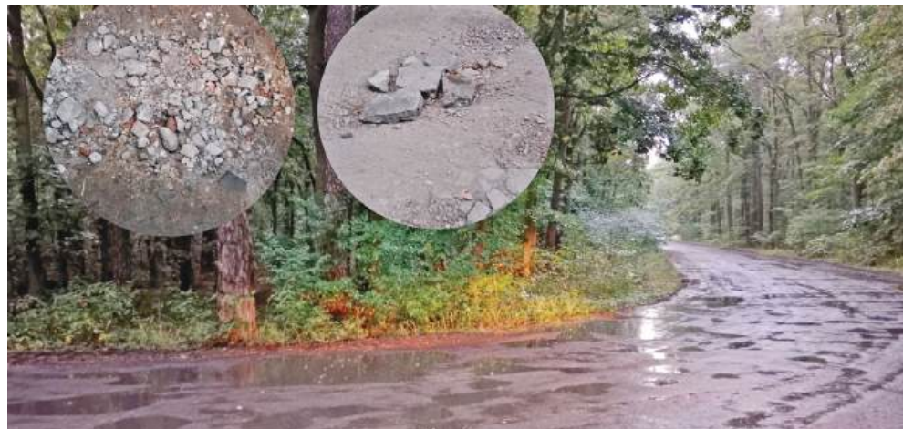
■ Droga po opadach deszczu. Na nawierzchni ponownie pojawiły się kałuże. Na mniejszych zdjęciach widać, że część ubytków została później zasypaana gruzem, w którym znajdują się ostre fragmenty materiału.
