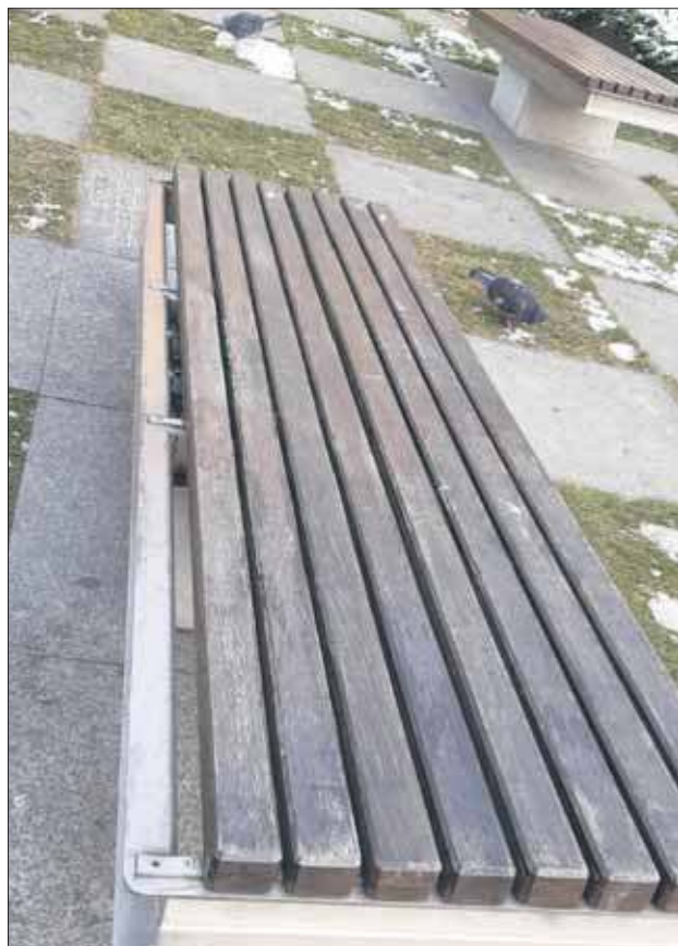
Równie i ławki wymagają naprawy
