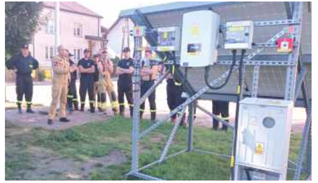
Do ćwiczeń wykorzystano specjalny trenera fotowoltaiki
