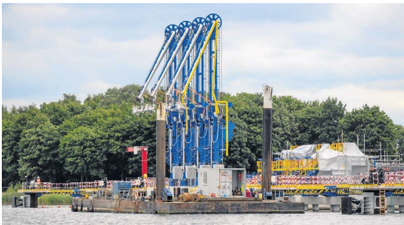
Terminal przeładunkowy wyposażono łącznie w osiem ramion nalewczych
