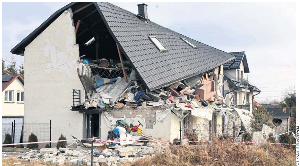
Wybuch spowodował poważne zniszczenia w piętrowym budynku jednorodzinnym
