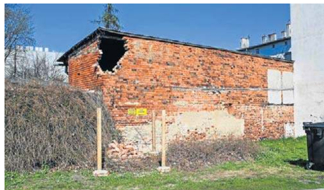
Ruina przy Grunwaldzkiej 111 zagraża mieszkańcom sąsiadnego budynku
