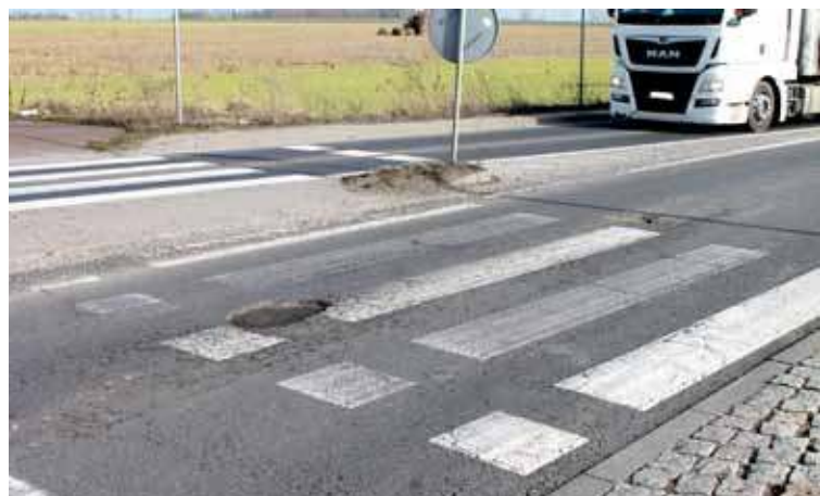
Ubytki, jak widać, są dość głębokie
