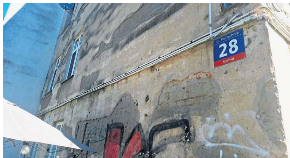
Z kamienicy sypie się tynk, klatka schodowa jest zagrzybiona i pozalewana. Schody się kruszą, metalowa balustrada ledwo się trzyma...
