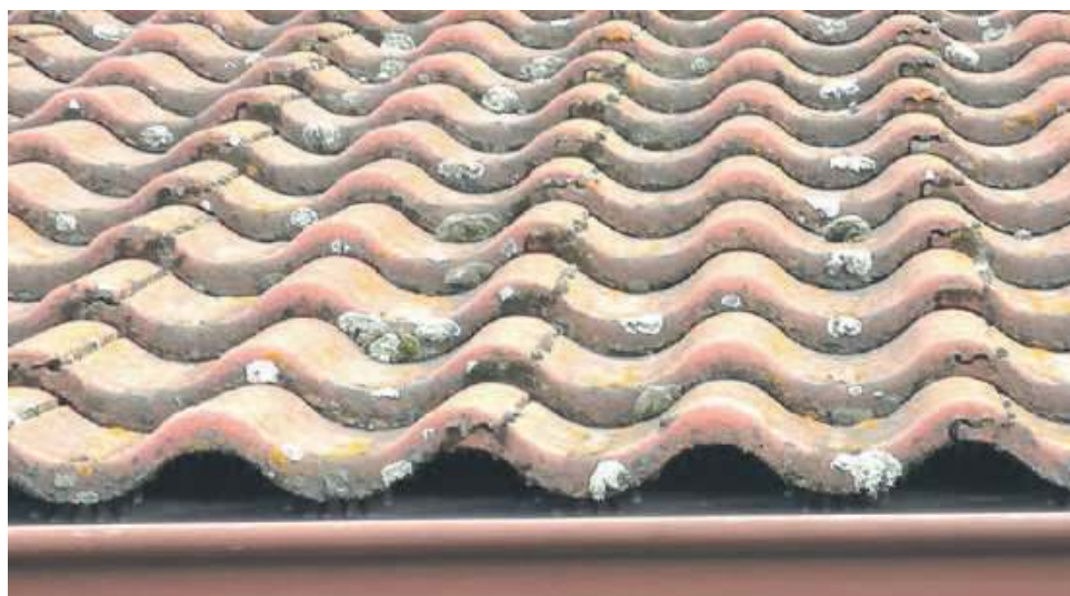
Pani Maciejewska uważa, że te dachówki zniszczył pył z drogi
