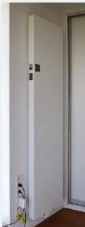
📍 Pionowe grzejniki dekoracyjne wyposażono w głowice termostatyczne.
