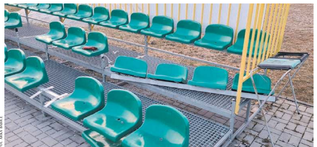
Zniszczona trybuna na obiekcie sportowym w Babicach
