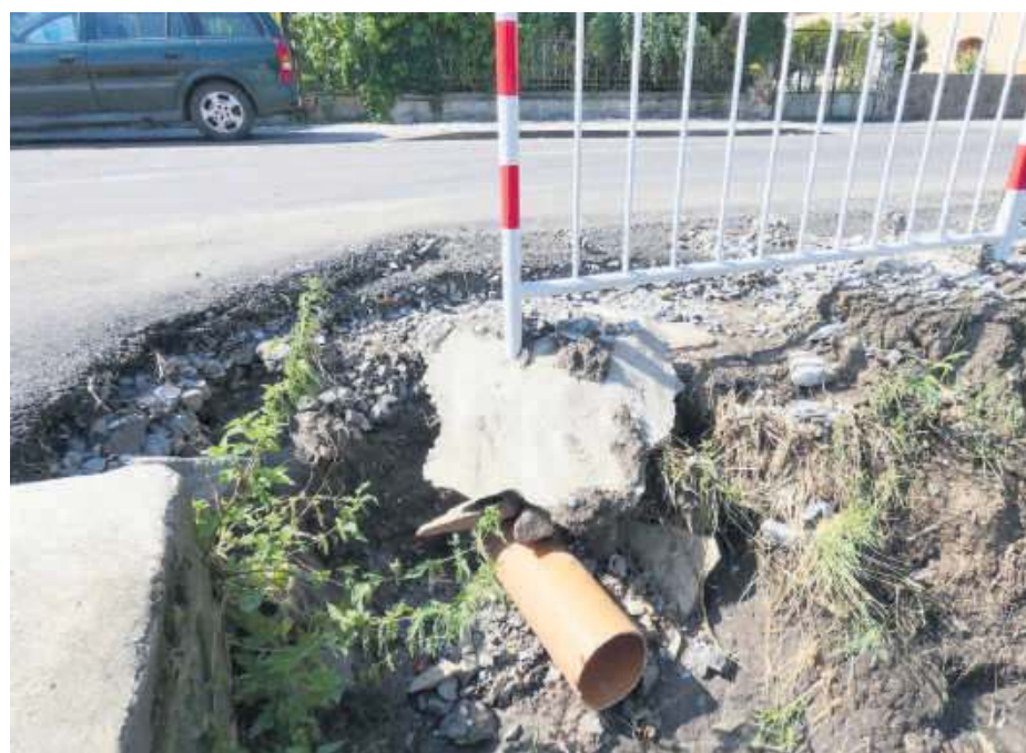
Tu widać, co nieskanalizowana woda jest w stanie zrobić z sytkim poboczem
