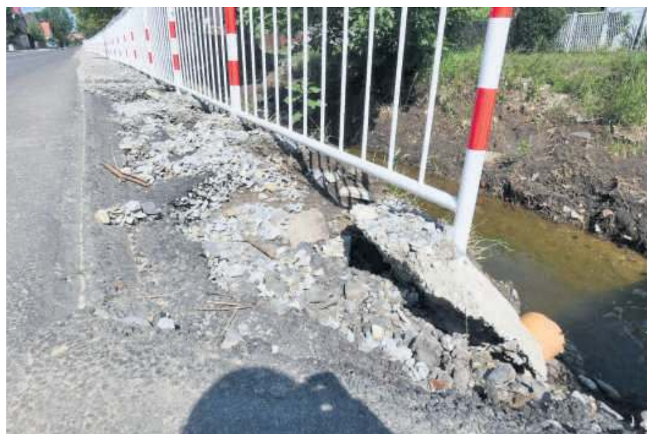
W centrum wsi fundament barierki ochronnej został tak podmyty, że aż się zsunął w stronę potoku
