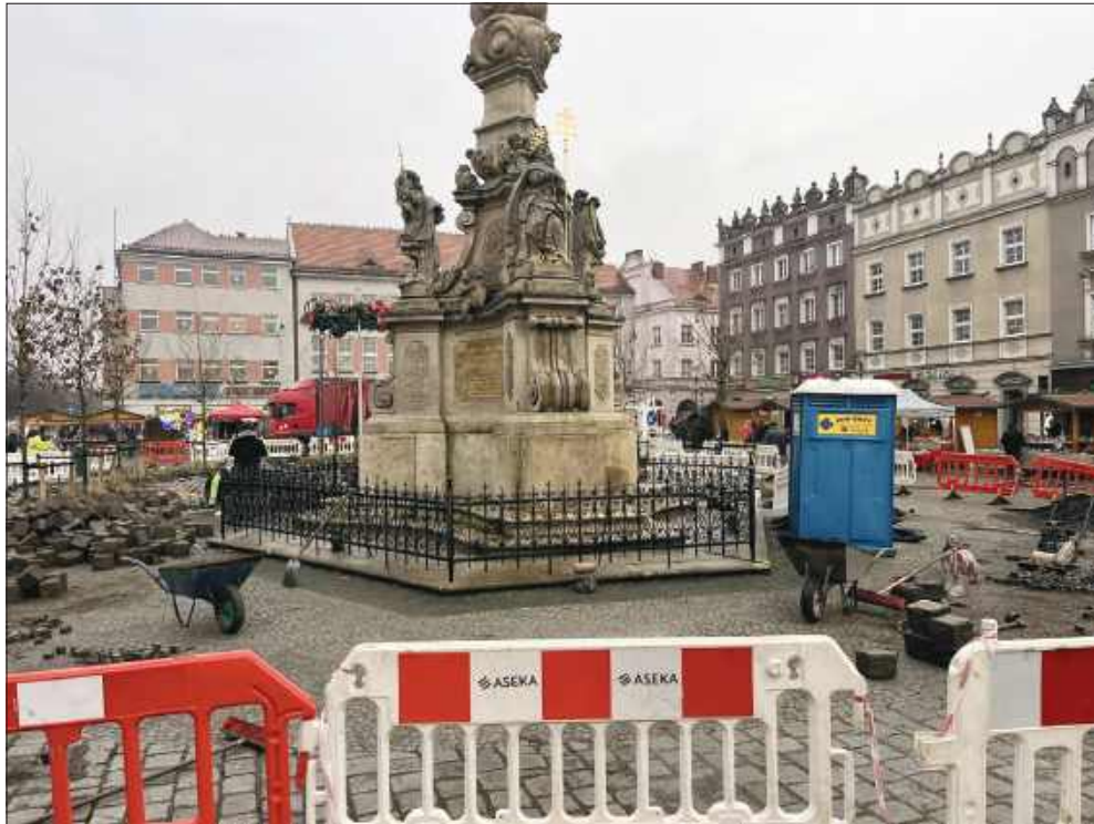
■ Pod koniec 2025 roku raciborski rynek był rozkopany w związku z nasadzeniami 18 platanów i 540 traw ozdobnych
