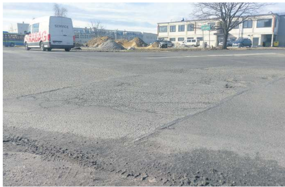
Droga w Szczawinie została niedawno przebudowana. Niestety, inwestycja nie objęła niewielkiego fragmentu przy skrzyżowaniu z drogą Strzelin-Zielenice
