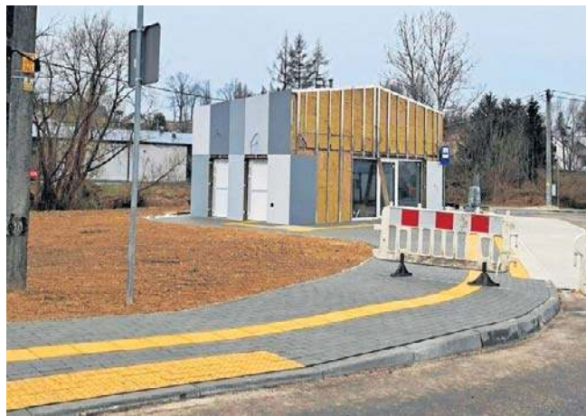
Zajezdnia i otoczenie ryglickiego dworca są już gotowe. Trwają prace przy budynku poczekalni z toaletami
