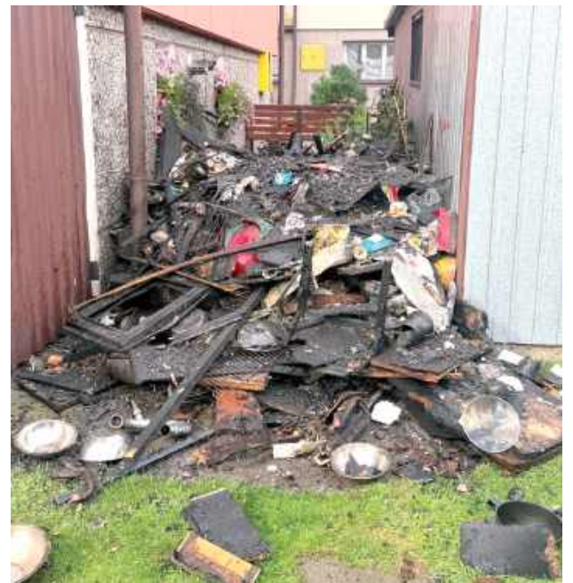
Spaleniu uległy pomieszczenia mieszkalne wraz z wyposażeniem. Ogień uszkodził również część więźby dachowej oraz elewację budynku (fot. OSP KSRR Ryki)
