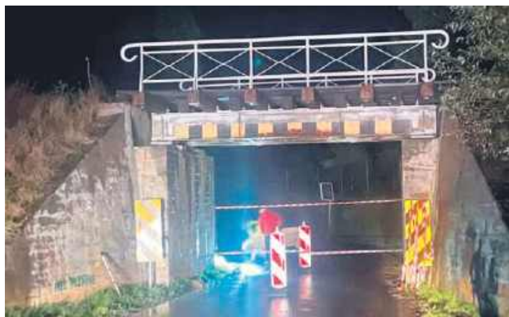
Do uszkodzenia wiaduktu, doszło we wczesnych godzinach popołudniowych. Fot. FB Gmina Śliwice
