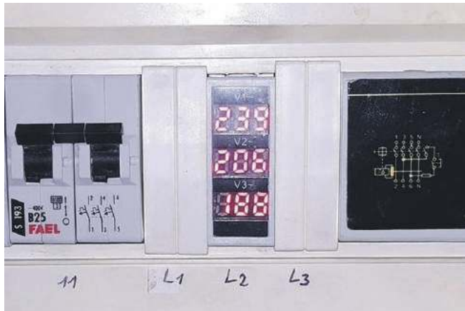
Pomiar urządzenia mierzącego napięcie. Tylko napięcie jednej fazy mieści się w granicach normy
