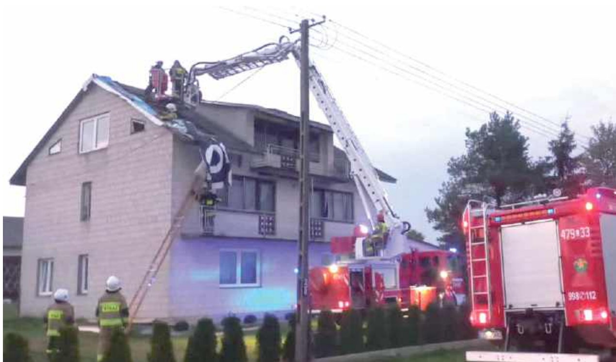
W sześciu przypadkach strażacy musieli interweniować przy zerwanych lub uszkodzonych dachach
