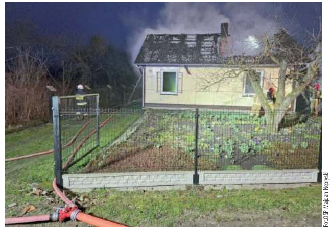
Budynek jest zniszczony w 80 proc. Wstępnie straty zostały oszacowane na około 150 tys. zł
