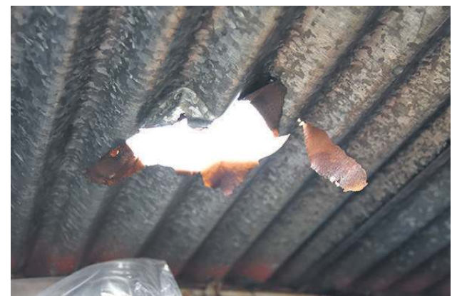
Dziura w metalowym dachu garażu. Zdaniem Michała Skąleckiego to efekt pirotechnicznych zabaw. Fot. Iz
