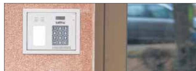
Aby domofon mógł być zainstalowany, potrzebna jest zgoda 80 proc. mieszkańców
