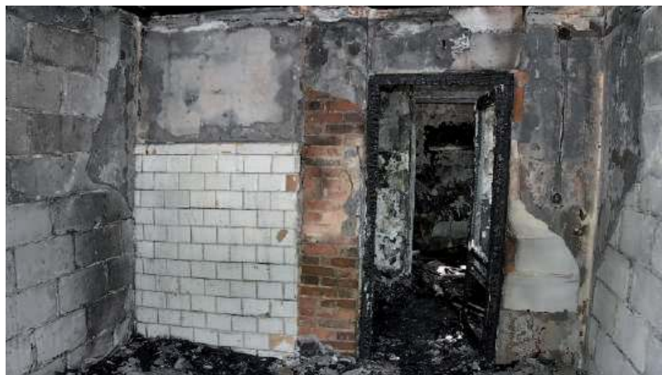
Skutki podpalenia niezamieszkałego domu
