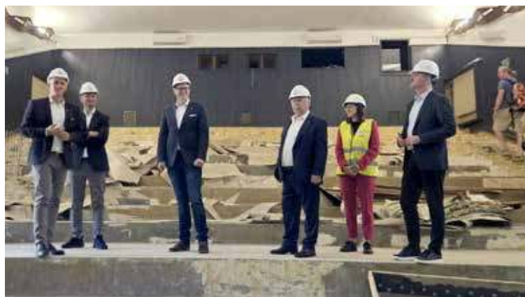
Zdjęcie z 12 sierpnia 2025! - uroczyste rozpoczęcie remontu Domu Kultury - zapamiętajcie te osoby na zdjęciu - to one (świadomie czy nieświadomie) legitymizują samowole budowlaną Wiatra - rozpoczął generalny remont bez pozwolenia na budowę.
