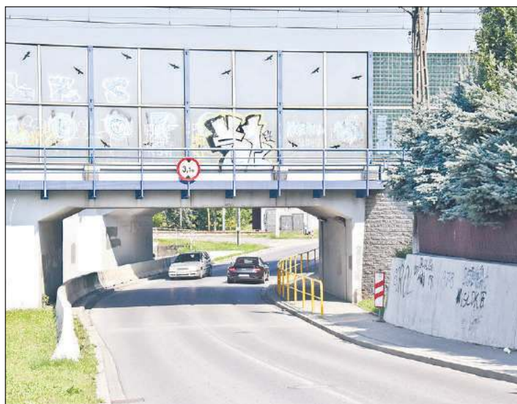
Wiadukt na Świętosława jest najbardziej zniszczony.
