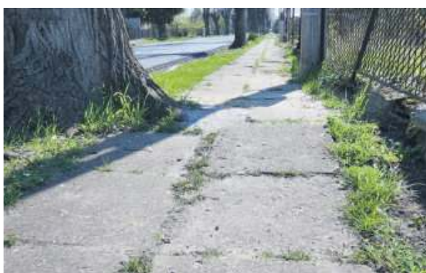
Niewątpliwie sporym problemem Starego Wiązowa są chodniki, które podniesione korzeniami drzew są nierówne i stanowią zagrożenie dla pieszych
