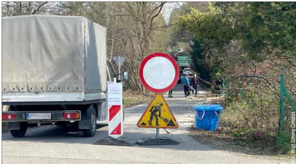
Ta droga będzie czasowo zamknięta.
