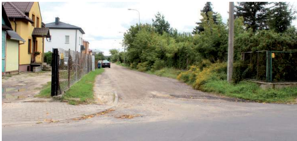
Tuż przed rozpoczęciem budowy ul. Kleeberga okazało się, że środkiem przebiega instalacja gazowa, która wcześniej nie była wykazywana na planach
