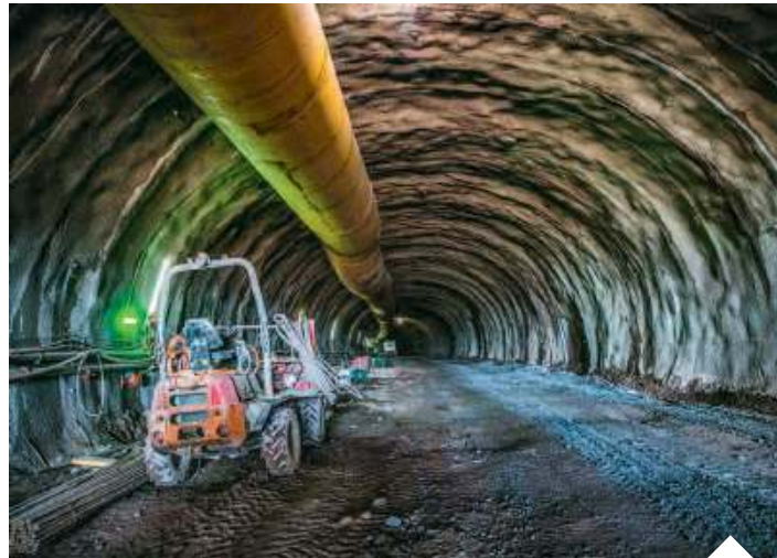
Ta żółta rura na górze służy do napowietrzania tunelu
