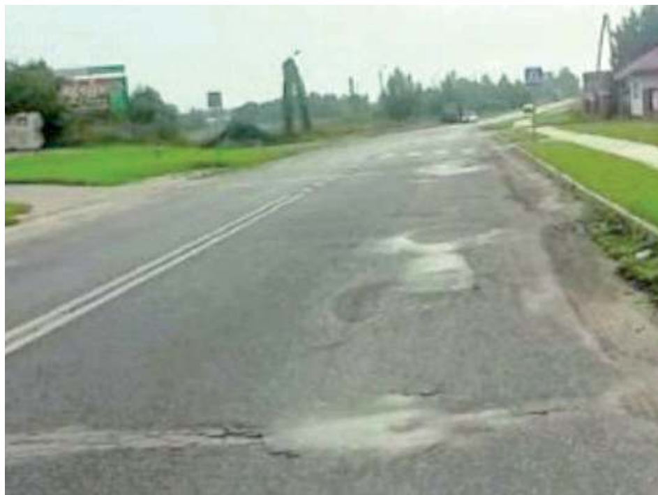
Droga jest w fatalnym stanie. Przebudowa obejmie wykonanie nowej konstrukcji i nawierzchni z betonu asfaltowego, wykonanie nowego chodnika z kostki betonowej, wykonanie ścieżki rowerowej o nawierzchni asfaltowej, wykonanie zjazdów i parkingów z kostki betonowej oraz wykonanie poboczy z kruszywa.
