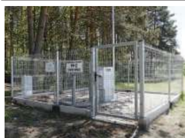
▲ Przepompownia Stare Króle
