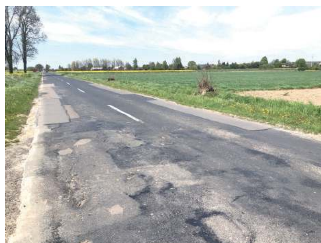
Jednym z najbardziej zdegradowanych odcinków drogi powiatowej 3011L (dawniej DW848) jest odcinek z Tarnawy Małej do Olszanki
