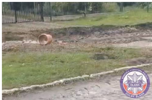
Na numer alarmowy 112 wpłynęło zgłoszenie o uszkodzeniu gazociągu
