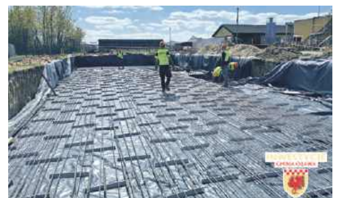
Oczyszczalnia ścieków w Stanowicach
