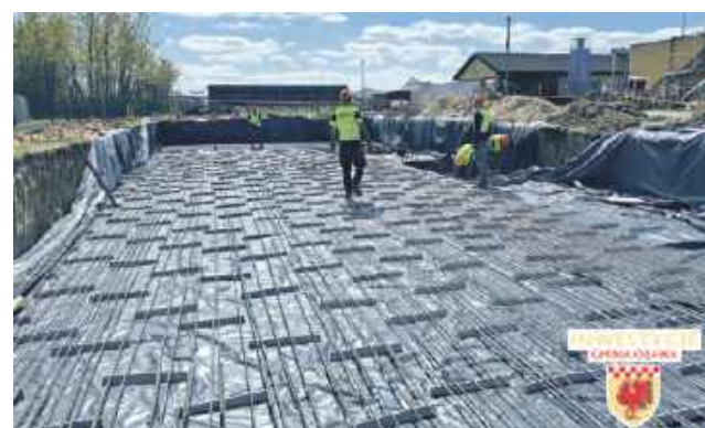
Oczyszczalnia ścieków w Stanowicach
