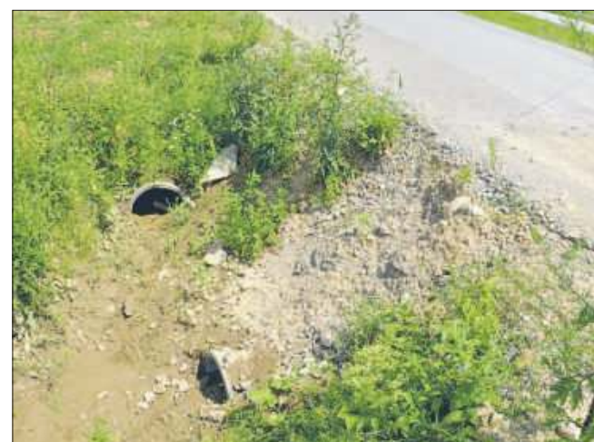
Po deszczu kamień spłynął do rowu.
