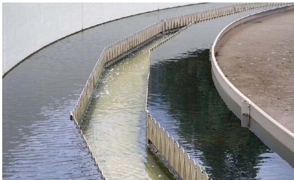
Oczyszczalnia ścieków w Józefowie, po modernizacji zużyje o połowę mniej energii
