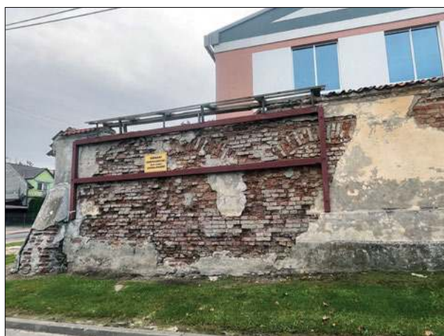
Mur przy Zespole Szkół od ul. Sienkiewicza wymaga pilnej naprawy. Obecnie zagraża bezpieczeństwu. Wreszcie zostanie wyremontowany
