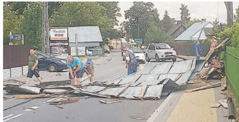
Nawałnica, która przeszła m.in. nad Ulanowem, zniszczyła w sumie dachy na siedmiu budynkach w całym powiecie
