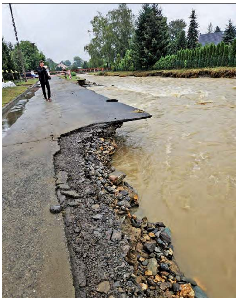
Zniszczona droga powiatowa w Moszczance
