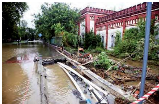
Zniszczone przez wodę ogrodzenie przy ul. Nyskiej
