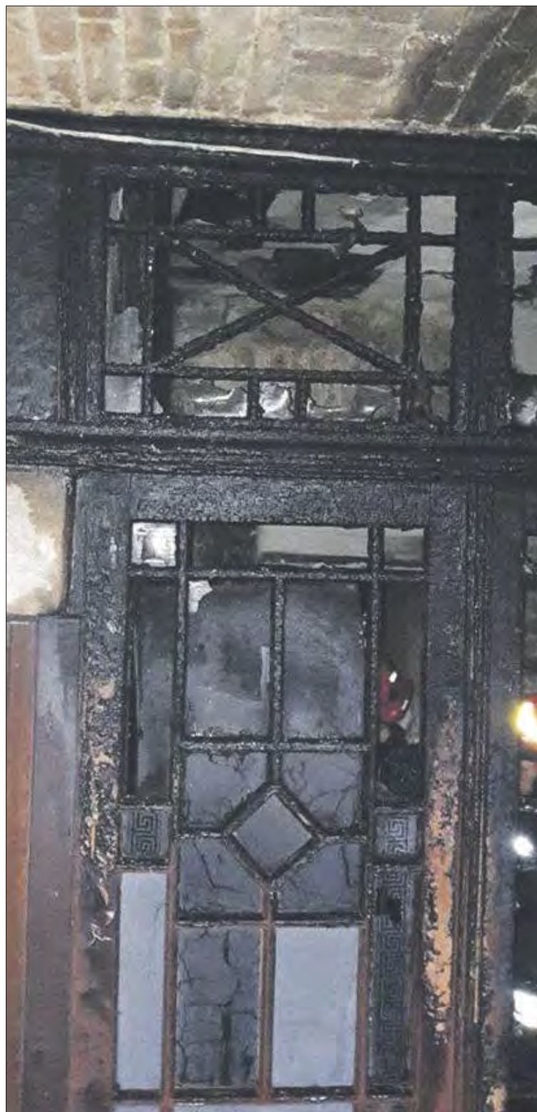
Pożar objął część kamienicy na ul. Szkolnej w Prudniku
