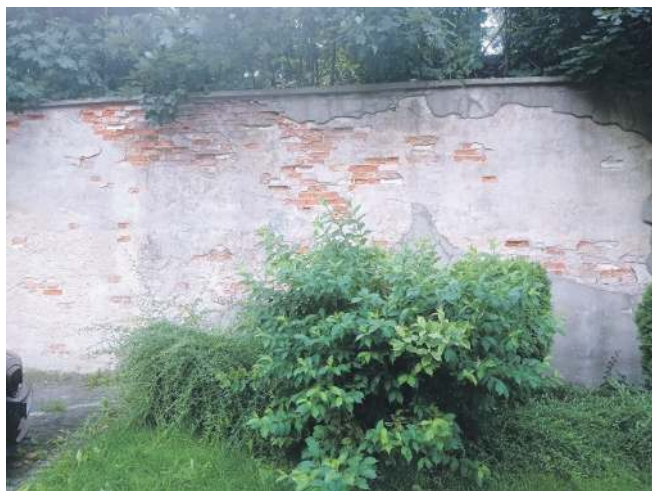
Z obmurowania odpadają duże fragmenty tynku
