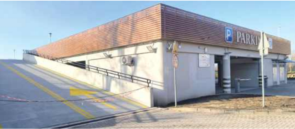
Obiekt został zamknięty niedługo po otwarciu ze względu na ujawnione usterki
