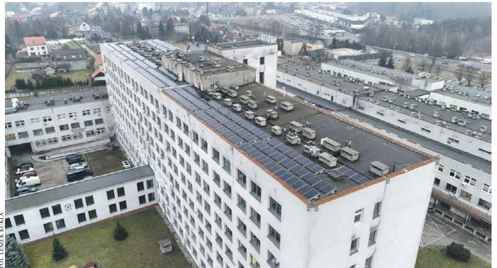
Na jednym z budynków szpitala zamontowano panele fotowoltaiczne
