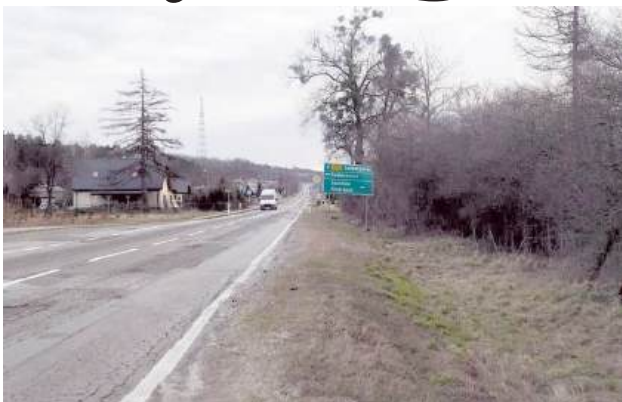
Stan drogi stwarza zagrożenie dla kierowców.
