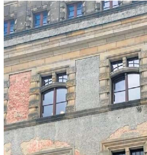
Elewacja budynku potrzebuje solidnej modernizacji
