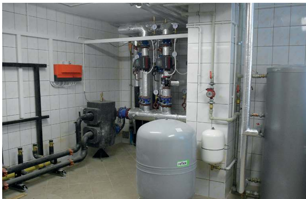
▲ Побудована і облаштована котельня
