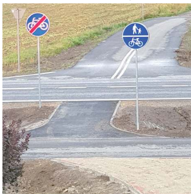
Mieszkańcy Tarnogrodu sprawdzili, ich nowa ścieżka rowerowa na ulicy Biłgorajskiej ma długość 3 m 80 cm, a jej szerokość to 195 cm. Ścieżka jest jednym z wielu drogowych absurdów, które zgłaszają nasi czytelnicy w związku z remontem DW835
