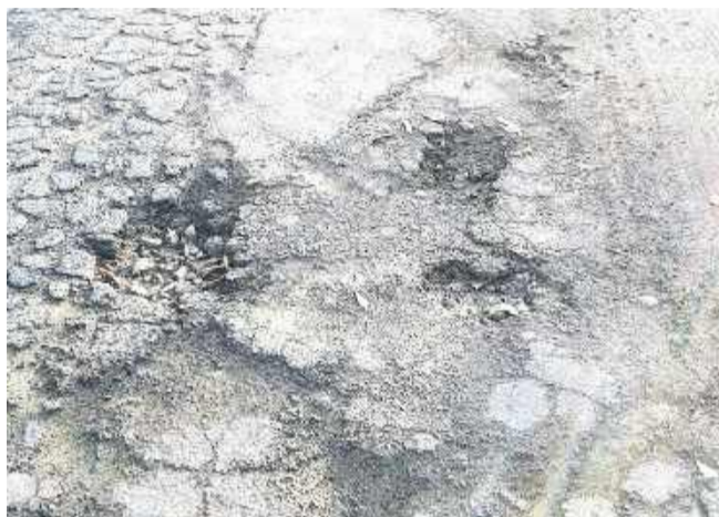
Nawierzchnia drogi do Piekar
